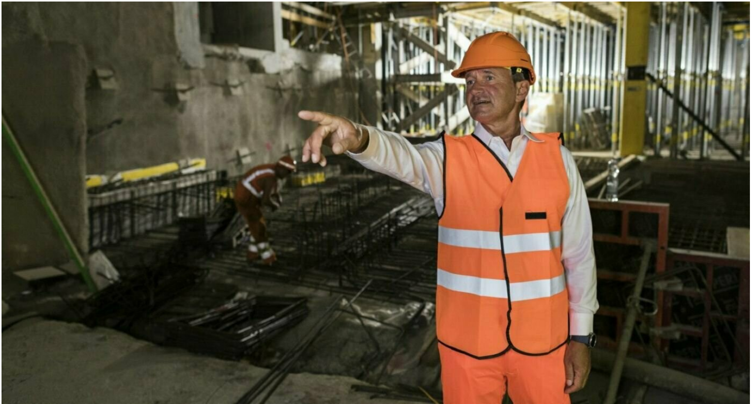
Benno Nussberger auf der ZBB-Baustelle unterhalb von Gleis 12/13 im Bahnhof Bern, wo die neue Unterführung ausgehoben wird. Zeitgleich erhöht Nussbergers Team wo möglich die Perrons für barrierefreies Ein- und Aussteigen.
