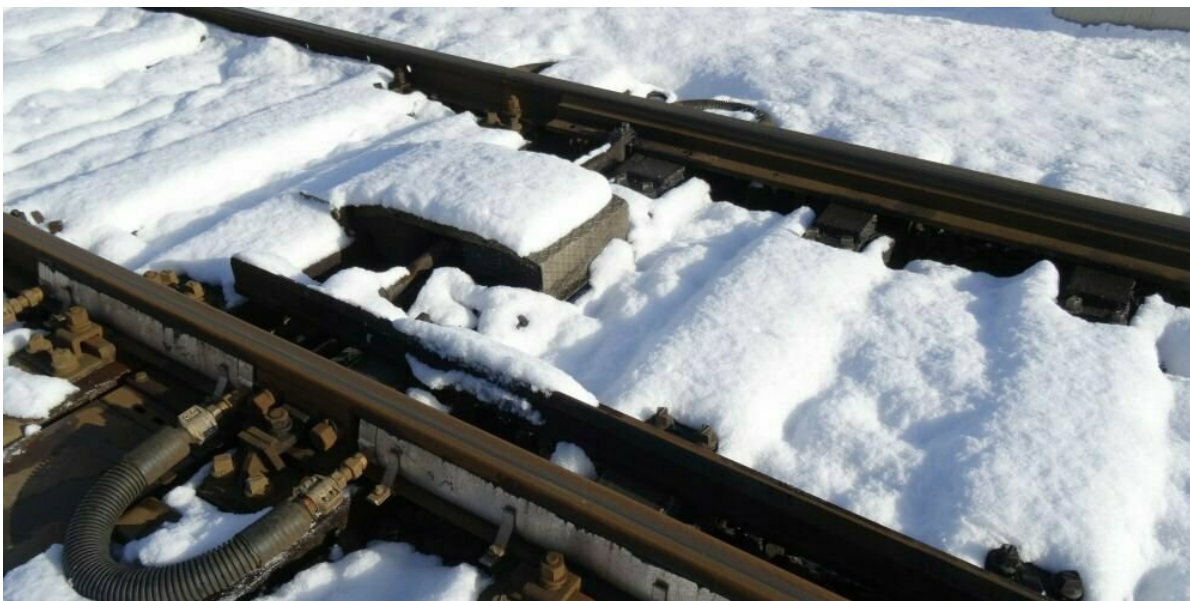
Rund 7400 Weichenheizungen sorgen bei der SBB für schneebefreite Gleise.
