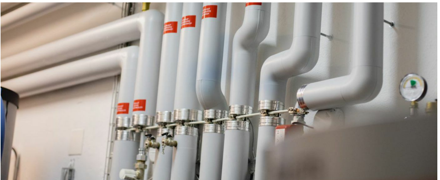
Ein Blick in den Heizungskeller des Bahnhofs Mägenwil.
