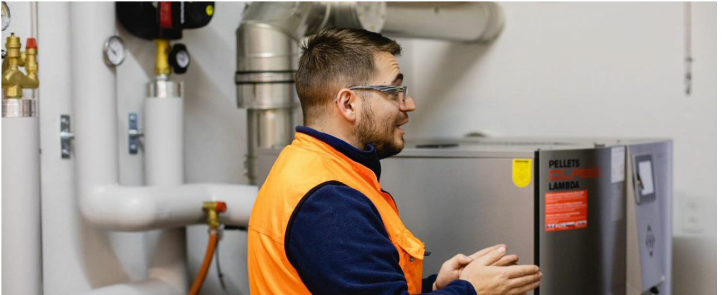
Anton Kqira erklärt, wie die neue Pelletheizung in Mägenwil funktioniert.
