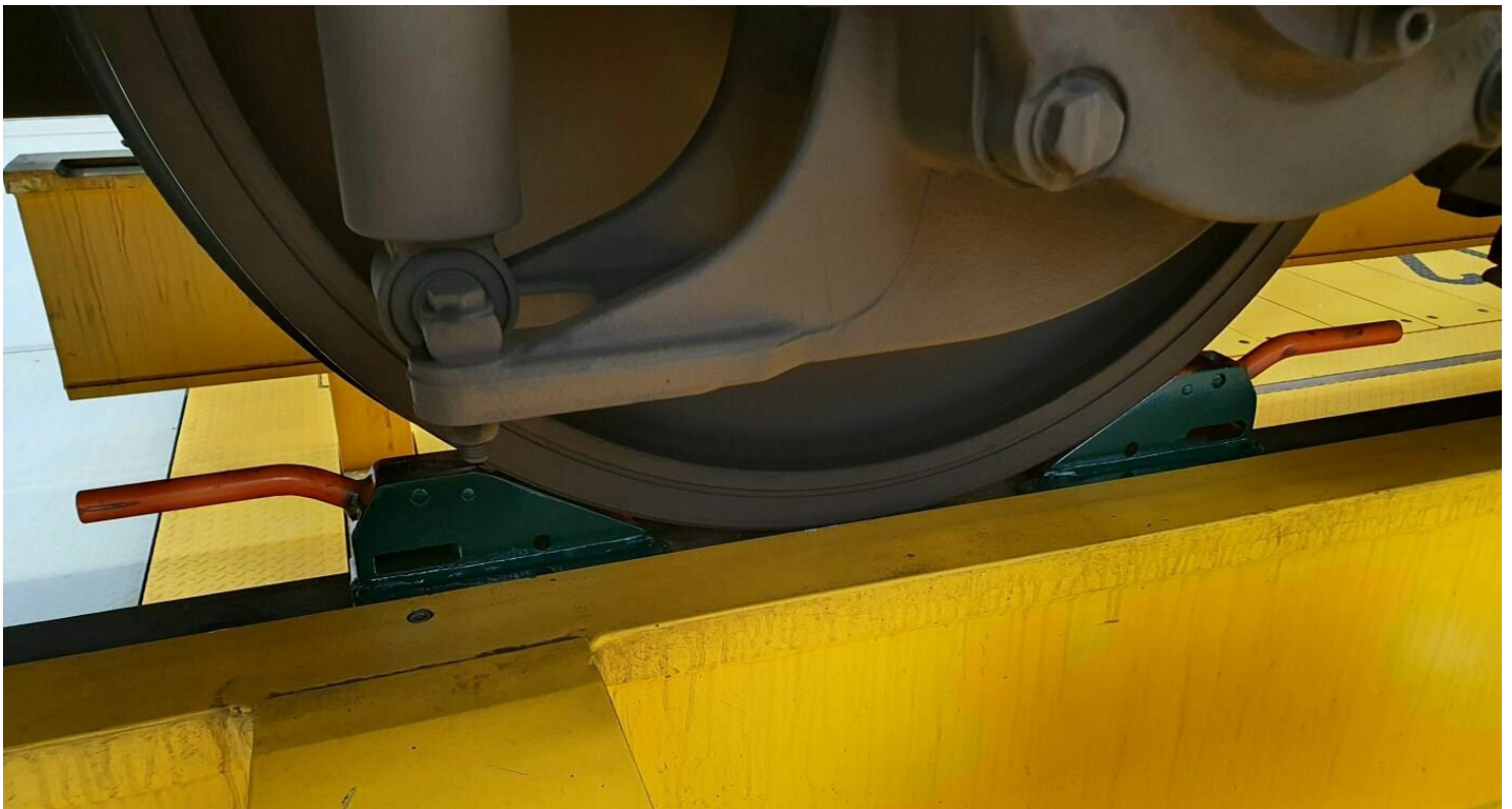
[12:11] Ryter Manola (KOM-IGK-BER1) Due blocca-ruote in uso nell'impianto di sollevamento sotterraneo.
