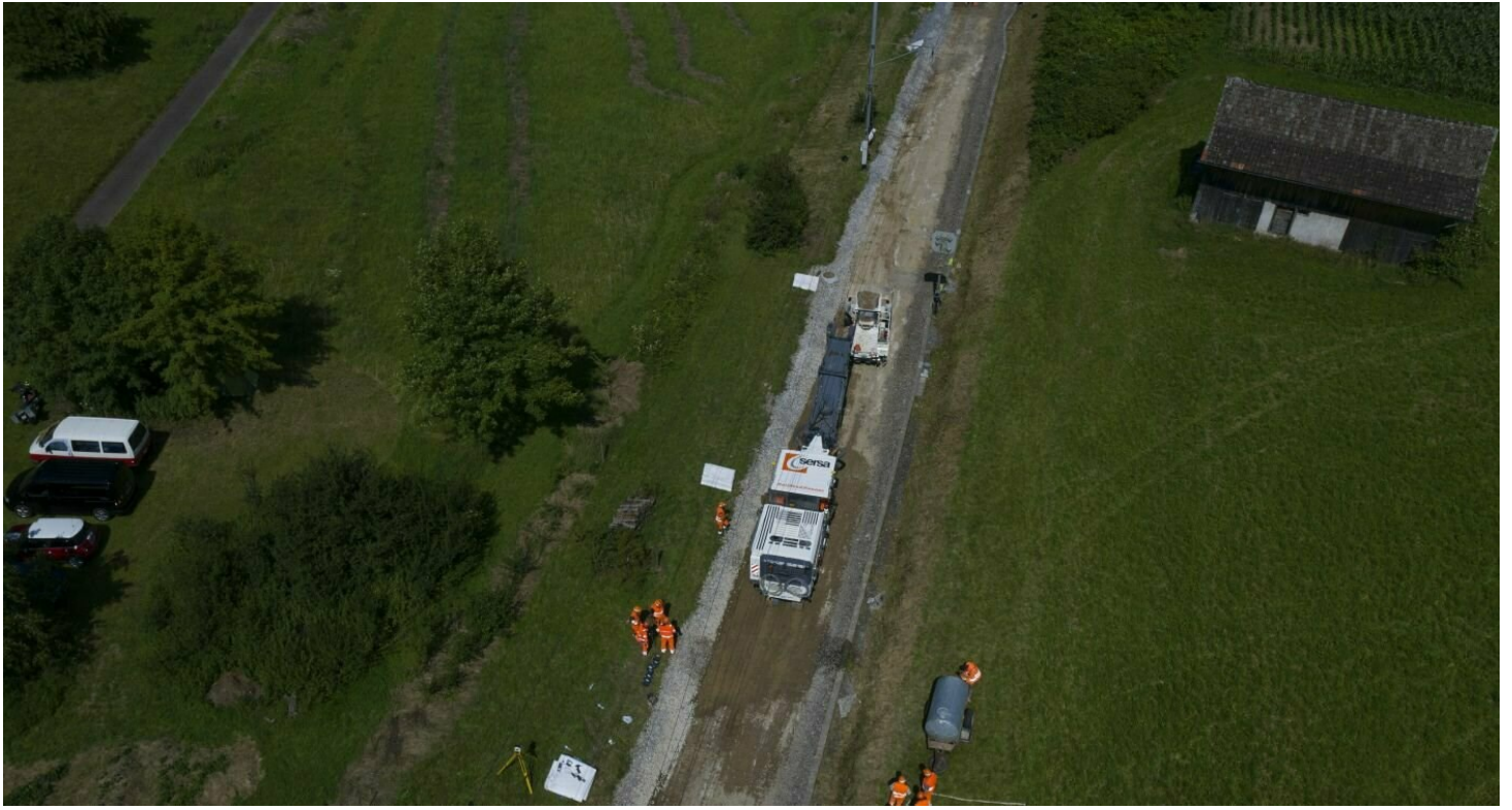
1/4 Die Bauteams erneuern die Gleise auf einer Strecke von rund 11 Kilometern. (drone-air-media.ch)
